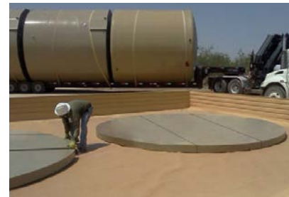
Pedestales para Tanques
