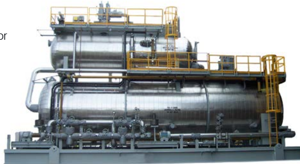
Unidad de Deshidratación de Crudos
