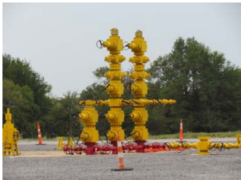
Cabezales de pozos
